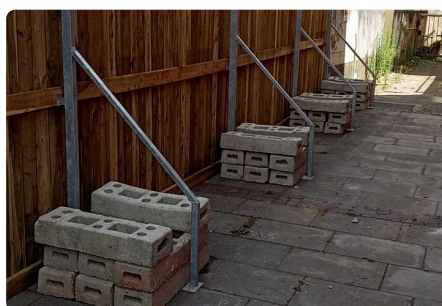
Ständer mit Strebe und Bauzaunfüßen am Gebäude
