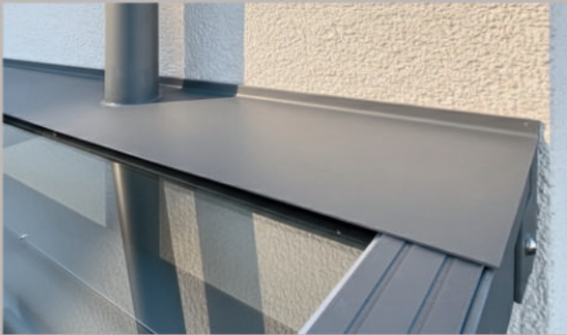
Fallrohr sauber integriert – kritischer Punkt, sauber gelöst
