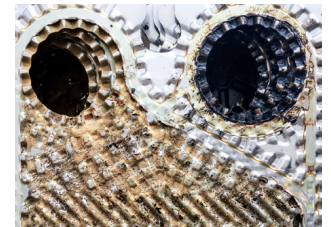
Kalkstein im Wärmetauscher
