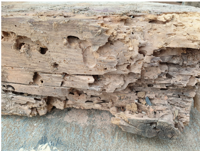
So sieht eine Fachwerkschwelle aus, wenn Insektenbefall und Feuchte sie von innen ausgehöhlt haben. Von außen oft kaum zu erahnen, bis man draufdrückt.
