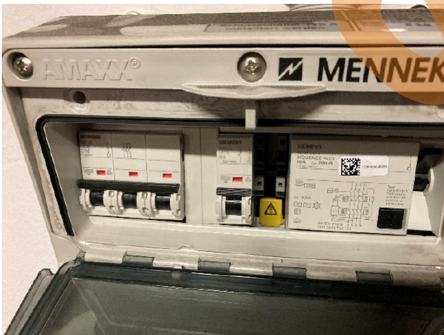
Bild 3: Fehlender Abdeckstreifen (Besuchergarage B-2/222-224)
