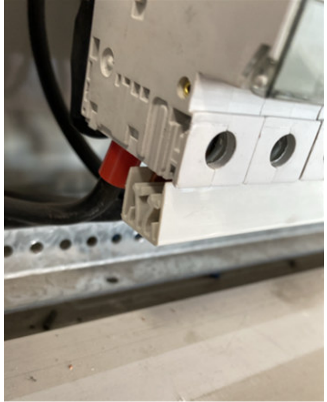
Bild 6: Fehlende Endkappe an Phasenschiene
