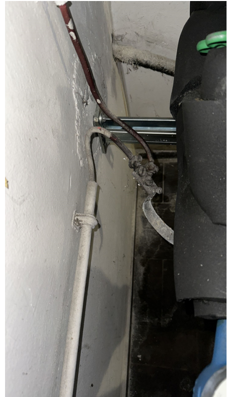
Bild 2: Fehlender Potenzialausgleich an Wasserleitung.
