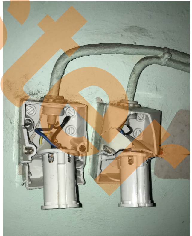
Bild 4: Defekte CEE Steckdosen.
