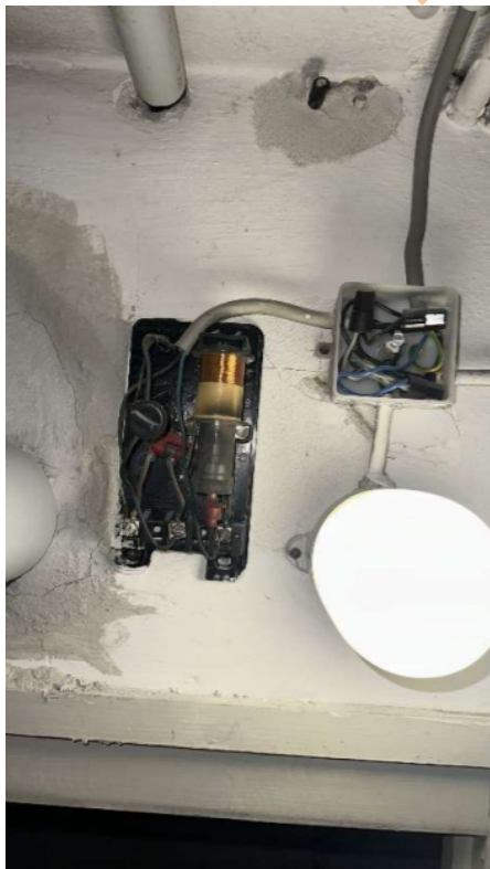
Bild 3: Abdeckungen an Schaltrelais und Installationsdose fehlt.
