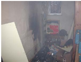
Blick auf die Brandstelle im Abstellraum
